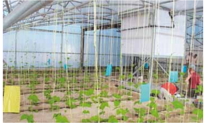
Über den herabhängenden Schacht strömt gekühlte Luft zurück
