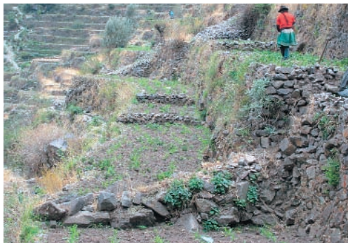
Verwildert, verlassen und durch Erosion gefährdet – so sehen heute große Teile der Terrassenhänge aus
